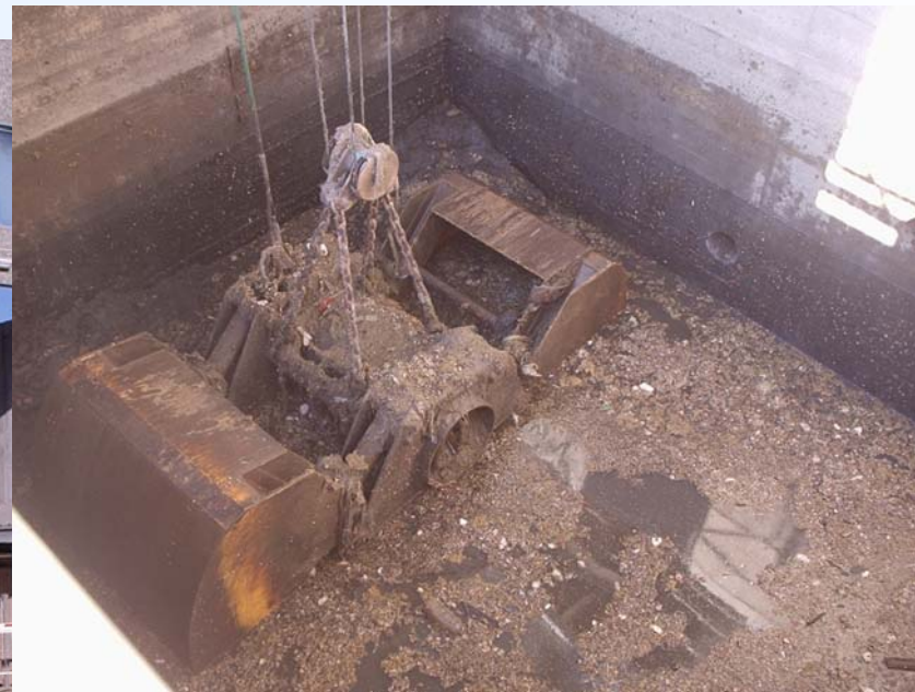
Benna robotizzata in fossa
