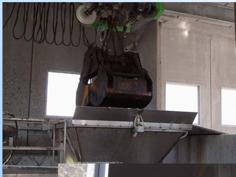
Dosaggio alimentazione vaglio
